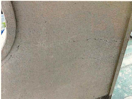
○明立小学校(外壁の亀裂)
