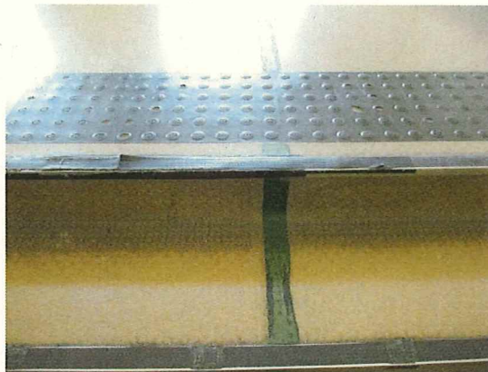
○阿賀小学校(階段の滑り止め)
