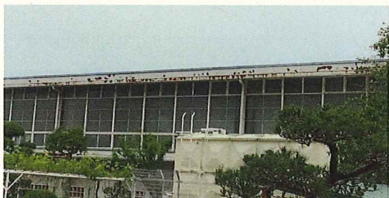
○昭和北小学校(校舎・プールの剥がれやひび割れ, トイレの老朽化)
